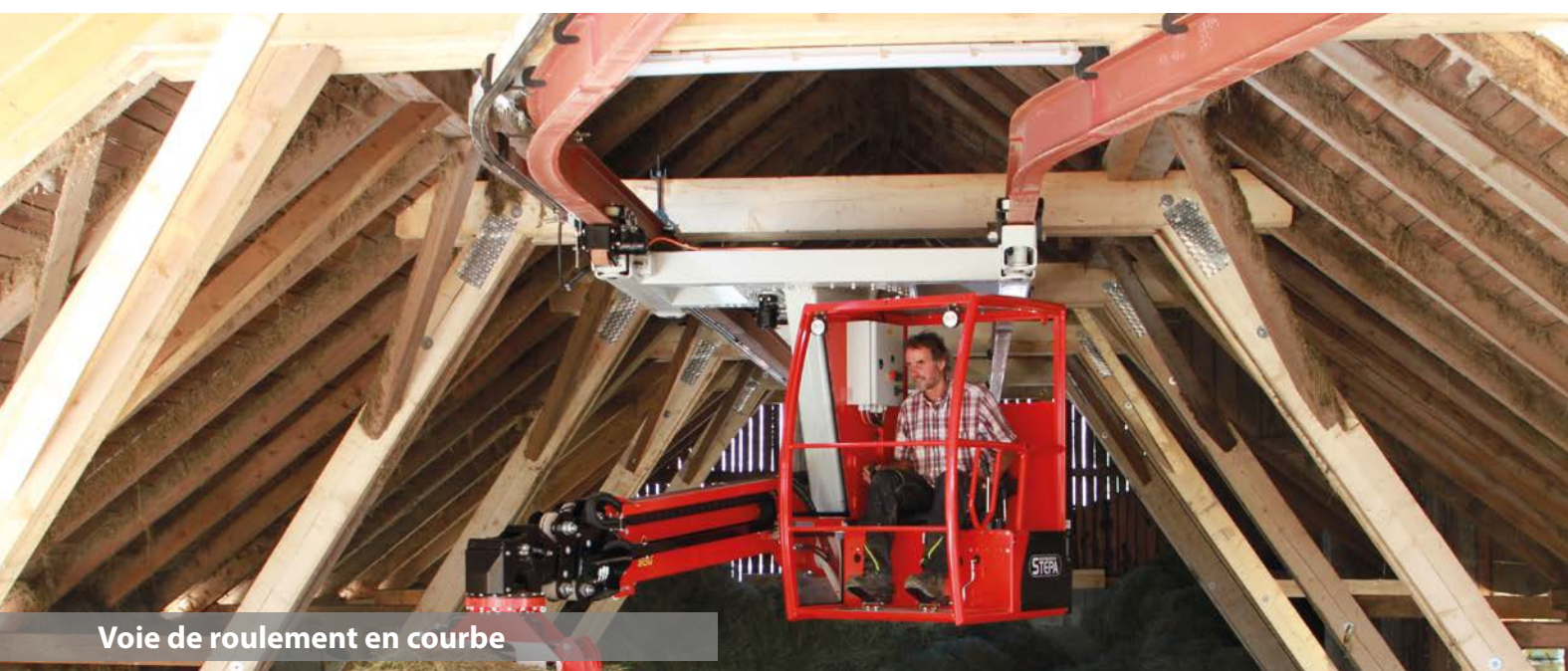
Voie de roulement traversante à chaînes
